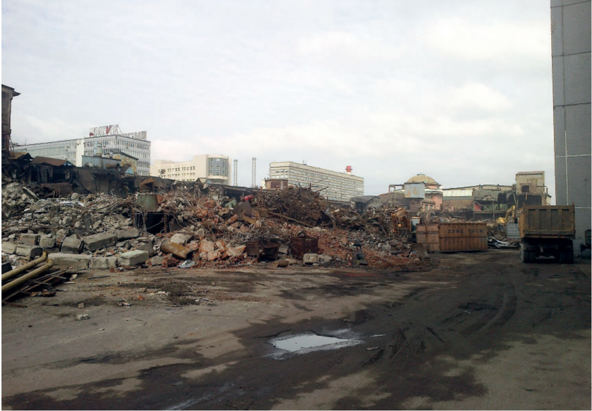
🔺 Руины Литейного цеха № 1. За ним видно здание заводоуправления АМО, где располагался музей. 28 мая 2013 г.
