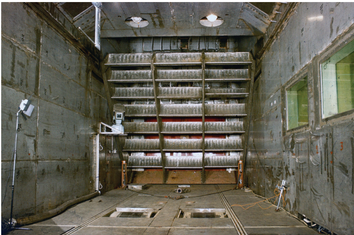
🔗 Вид на направляющий аппарат холодильной камеры
